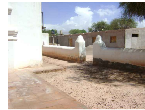
Nivel vereda perimetral sin drenajes agua de lluvias.
