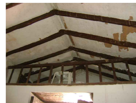
Inestabilidad de entrepiso coro y baranda.
