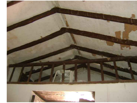
Inestabilidad de entrepiso coro y baranda.
