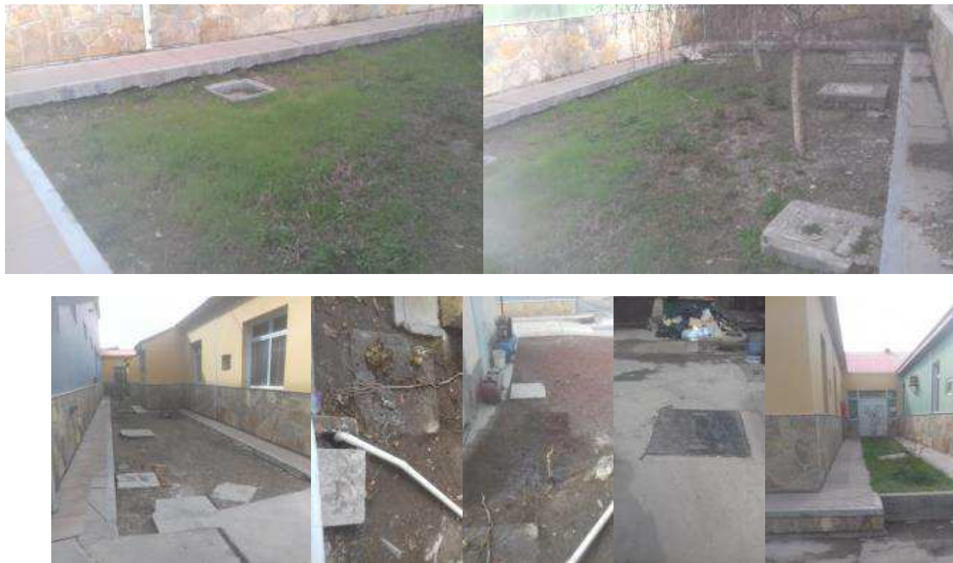
Foto N° 10: Vista de cámaras de inspección de efluentes líquidos.
