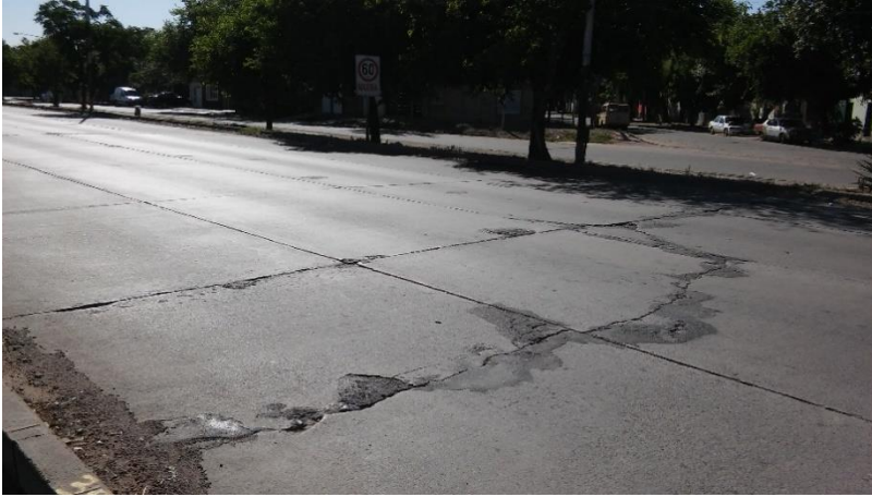
Foto: Deterioros actuales en Av. Costanera
