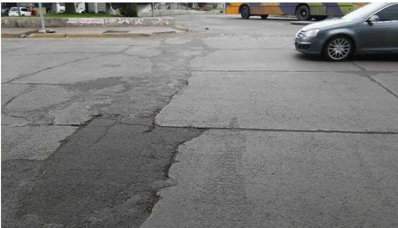
Foto: Deterioros actuales en Av. Costanera
