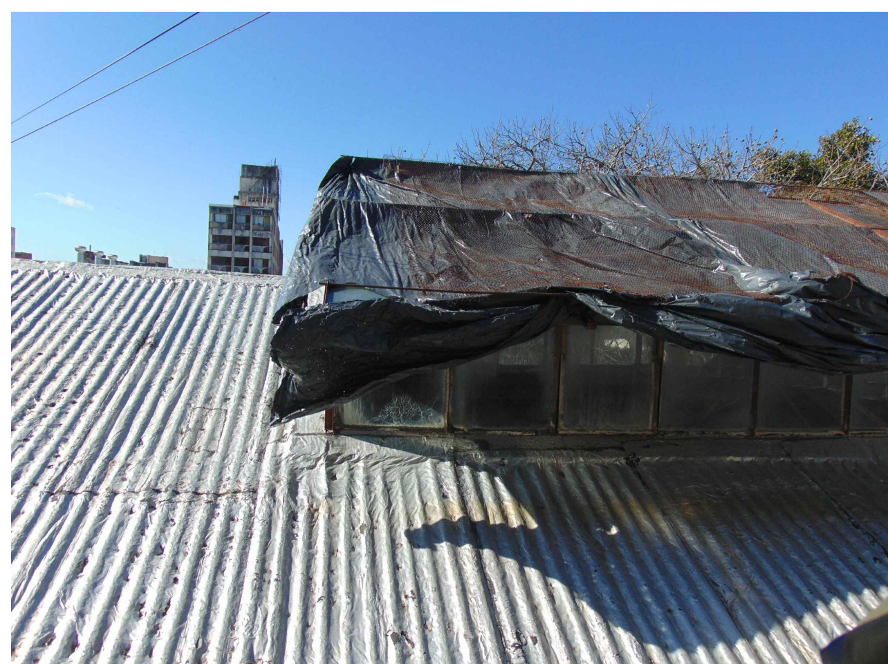
Situación de la cubierta y claraboya existente. La Propuesta respeta los niveles actuales de cubierta y claraboya existentes.
