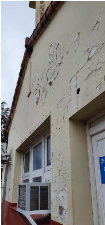
Ilustración 37. Falta mantenimiento exterior.
