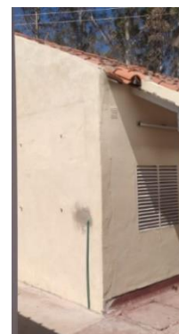
Ilustración 60. Sala de tableros
