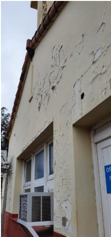
Ilustración 37. Falta mantenimiento exterior.
