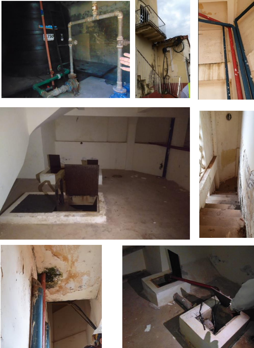
Ilustración 217. Imágenes correspondientes al tanque de reserva.
