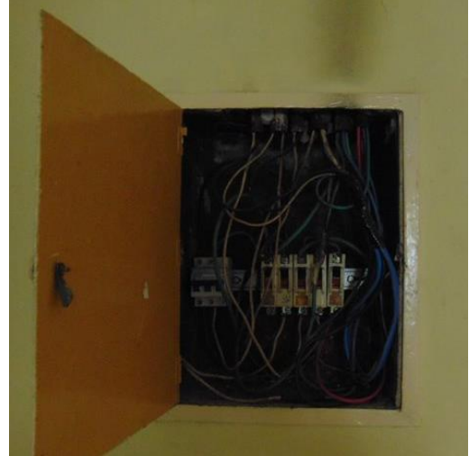
Ilustración 69. Tablero depósito SENASA
