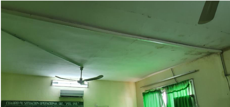
Ilustración 231. Locales mal iluminados con conexiones mal resueltas
