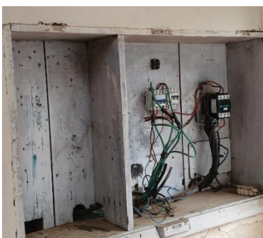
Ilustración 65. llaves electromagnéticas tanque de reserva
