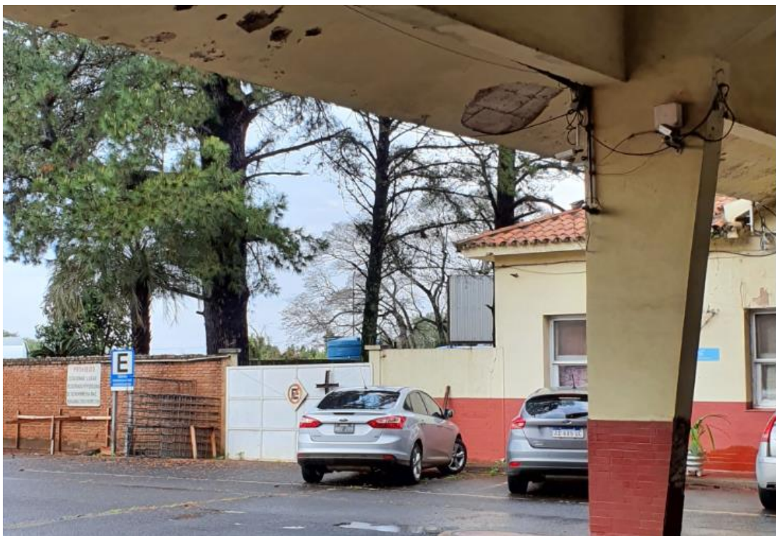
Ilustración 27. Desprendimientos de cielorraso aplicado por filtraciones
