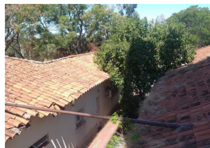
Ilustración 18- Cubiertas correspondientes a Baños y deposito (tejas dañadas, sin mantenimiento y con vegetación)
