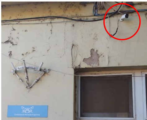
Ilustración 72. cámara ubicada en sector edificio de GNA
