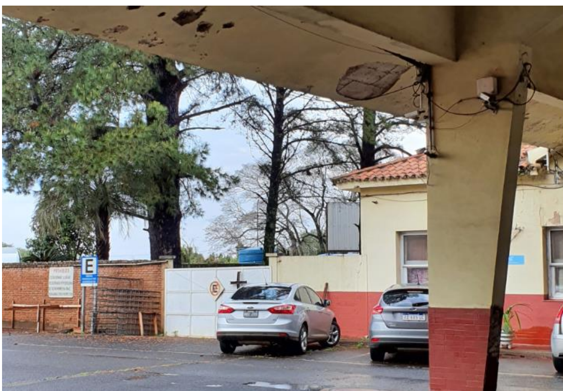
Ilustración 27. Desprendimientos de cielorraso aplicado por filtraciones
