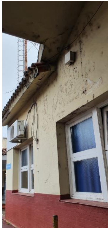
Ilustración 38. Falta mantenimiento exterior.
