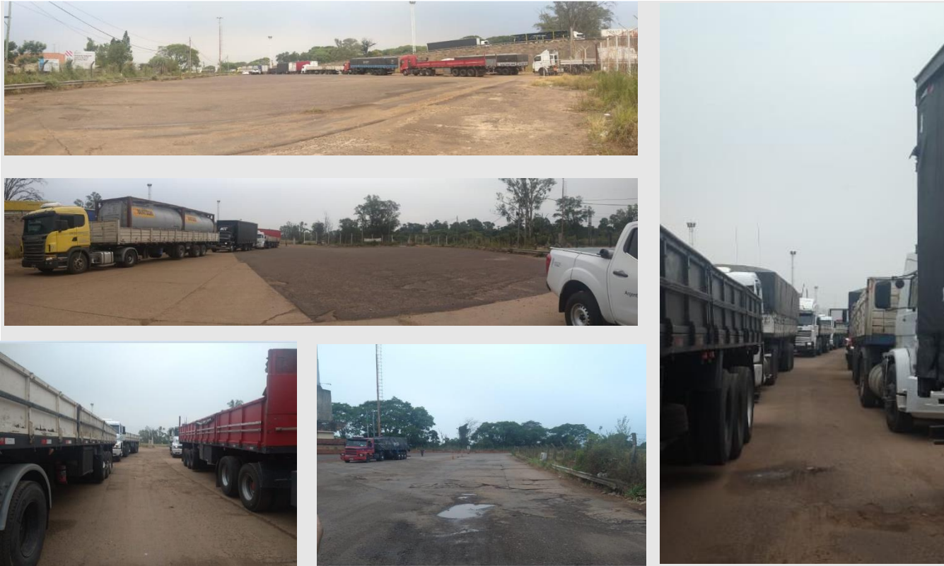
Ilustración 78. Mal estado del pavimento en el sector de tránsito pesado
