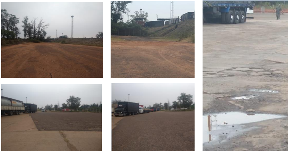
Ilustración 77. Sector tránsito pesado. Conviven distintos tipos de pavimento, en mal estado
