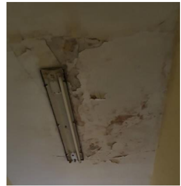
Ilustración 62. Bocas desafectadas por filtraciones
