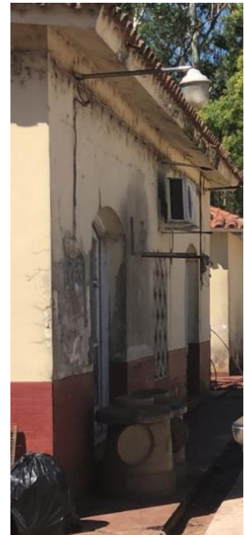
Ilustración 3912. Falta mantenimiento exterior.
