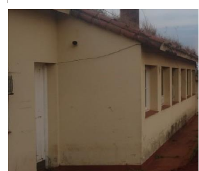
Ilustración 36. Falta mantenimiento exterior y humedad ascendente
