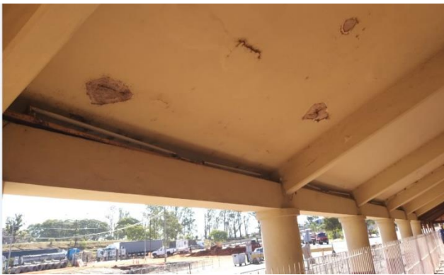
Ilustración 70. Tubos fluorescentes. Instalación precaria en galería
